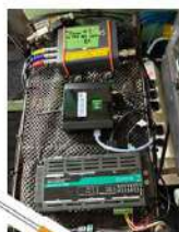
▲GNSS受信機 補正情報受信機 深度取得ユニット
